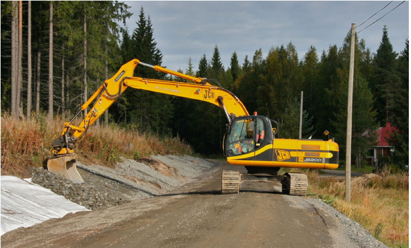
ROADEX demonstration project for an eroding embankment and ditch on Road 16583 Ehikki-Juokslahti, Finland. (photo: Iikka Hyvönen)
